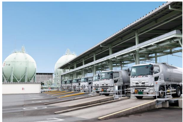
600tLPGタンク×2基とローリー出荷設備
